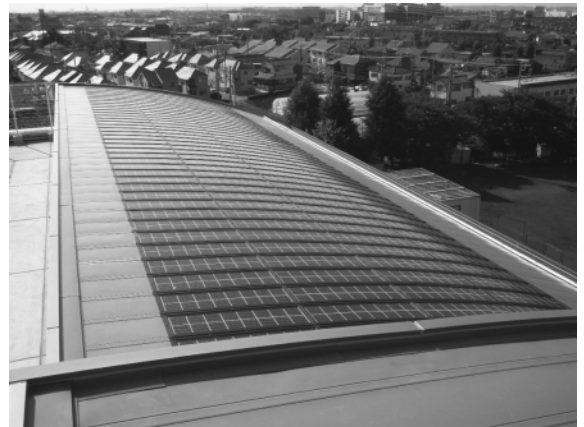
第一中学校校舎屋上に設置した太陽光パネル
