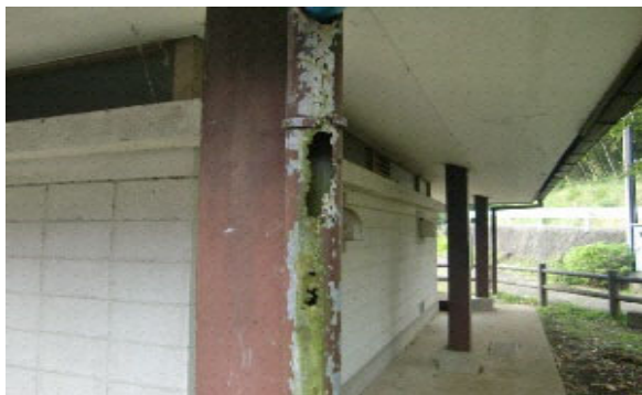
損傷(穴)(更衣室)
