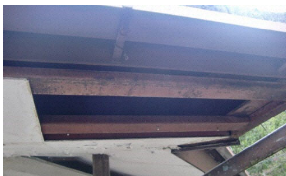
軒天井のパネルはずれ(更衣室)
