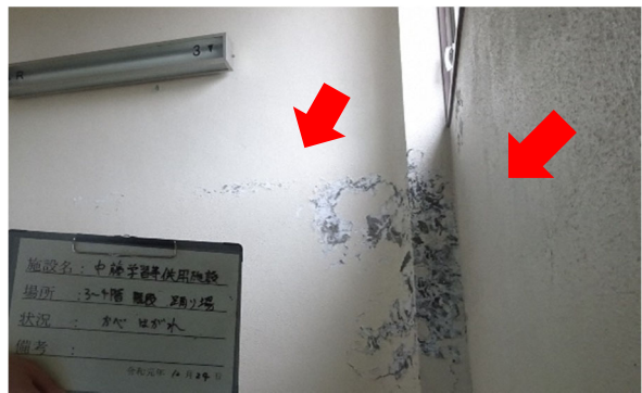
塗装剥がれ (中藤地区学供)
