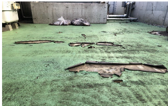
地下水湧出のため防水層が破れやすいと考えられる。
