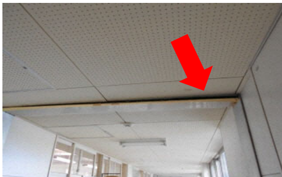
連結部分の部材破損 (第十小学校)
