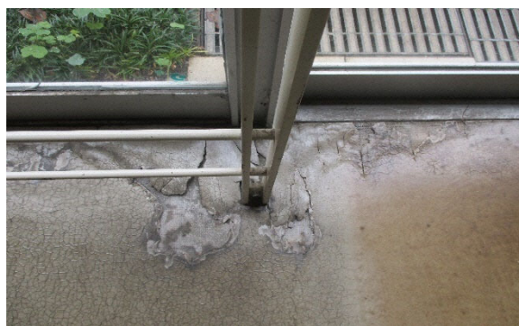
入り口周りの漏水痕
