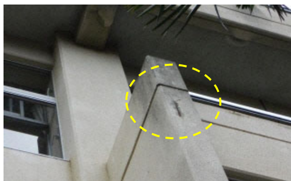
爆裂 (第五中学校)
