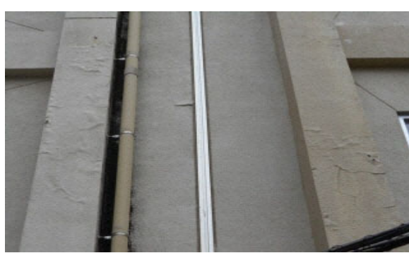
ひび、浮き (雷塚小学校)
