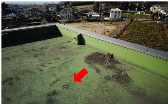
防水層の膨れ・破れ
