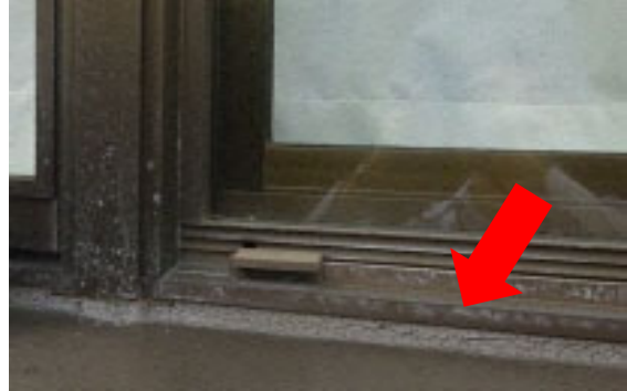
窓枠パッキンの劣化 (残堀・伊奈平地区学供)
