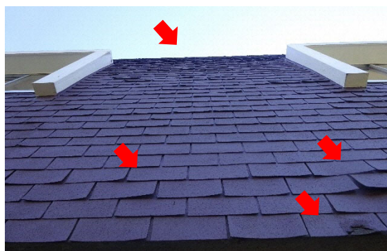
瓦タイルの変形・浮き・欠け（福祉会館）
