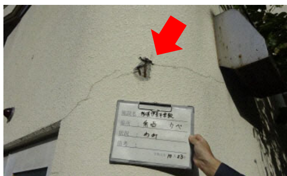
ひび、爆裂（鉄筋露出）（残堀・伊奈平地区学供）
