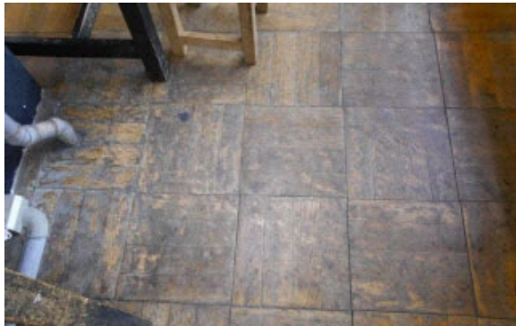
汚れ (第一中学校 (特別教室棟))
