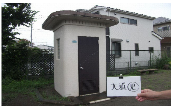
扉に軽微な傷（へこみ）あり
