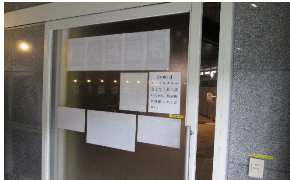
扉の動作不良
