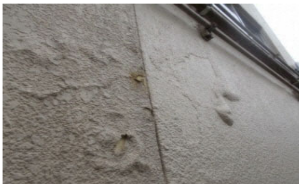
外壁の膨れ・めくれ (内部への漏水あり) (第二小学校)
