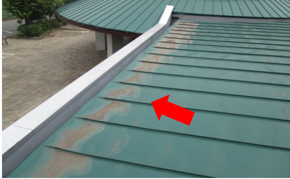
部分的な汚れ
