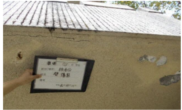
爆裂 (雷塚小学校)
