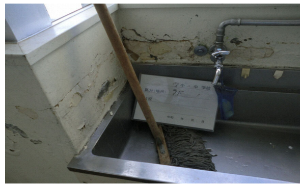
校舎水飲み場壁剥がれ (第七小学校)
