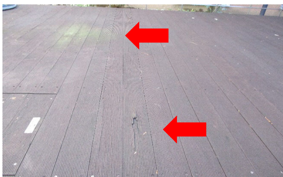
木部割れ、汚れ (苔)
