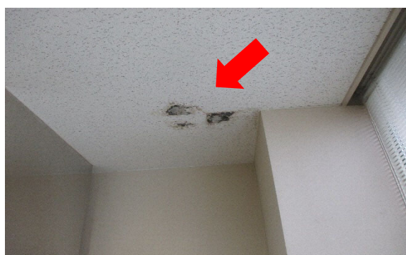
汚れ・染み (漏水が疑われる)
