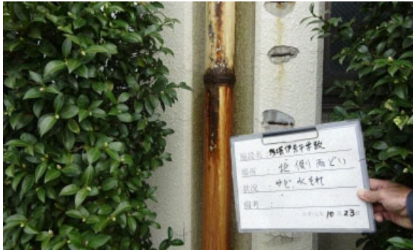
外壁の爆裂 (鉄筋露出)、雨どいの汚れ・金具のさび (残堀・伊奈平地区学供)
