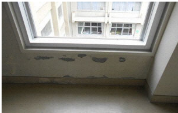
仕上げ材の剥がれ (雷塚小学校)
