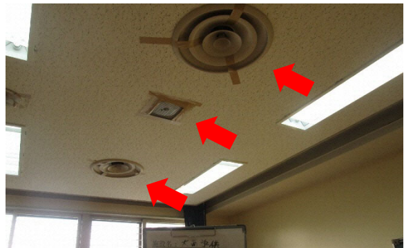
空調・非常灯のがたつき (大南地区学供)
