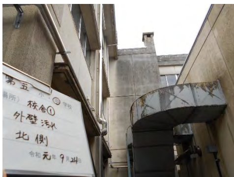
外壁：汚れ (b)
