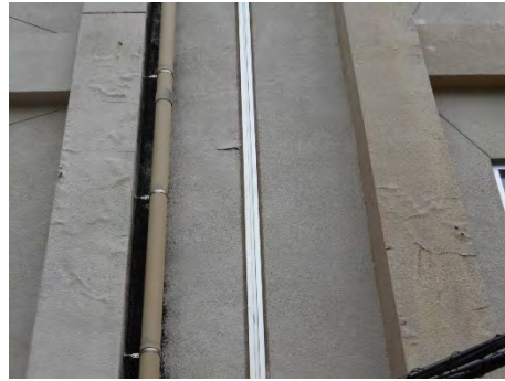
外壁：膨れ、ひび (c)
