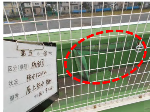
屋上：防水シート剥がれ (d)
