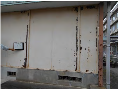
外壁：さび (c)
