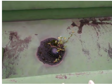
屋上：植生、排水口詰まり (d)
