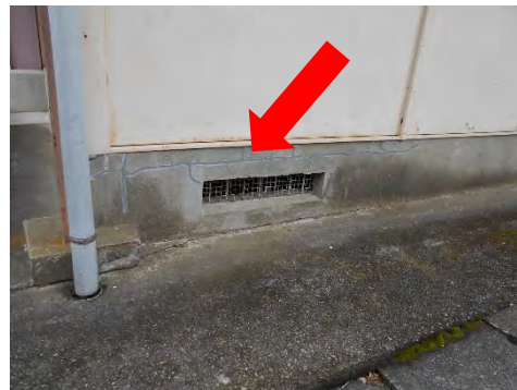
基礎・土台：ひび (c)
