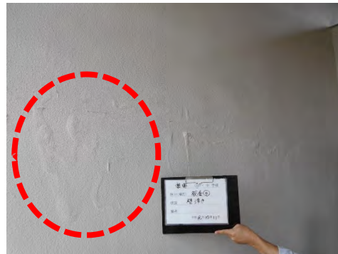
内部壁：浮き (b)
