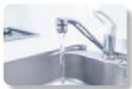
蛇口の水漏れ
