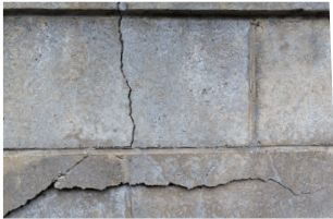
危険なブロック塀
