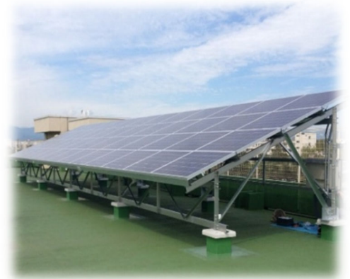
太陽光発電設備
